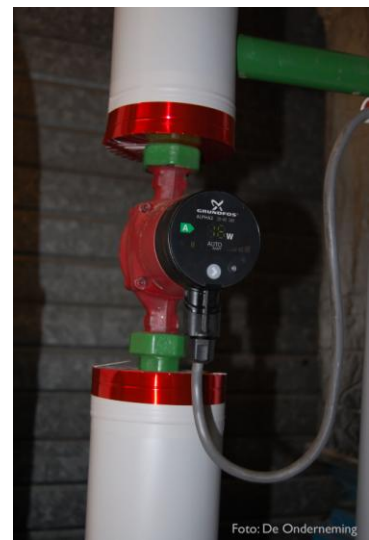
Door een beter hydraulisch concept en het gebruik van moderne pompen daalde het pompverbruik met 95%.
