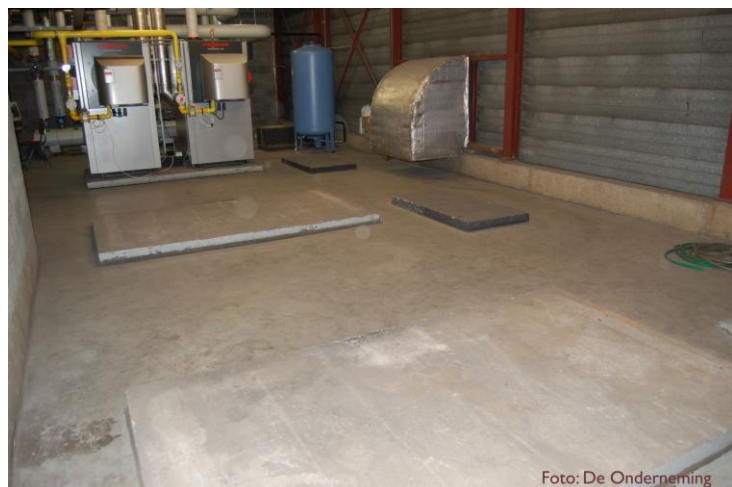
De drie bestaande ketels werden vervangen door twee Viessmann condensatieketels. Aan de sokkels kan men zien dat de nieuwe installatie heel wat compacter is.
