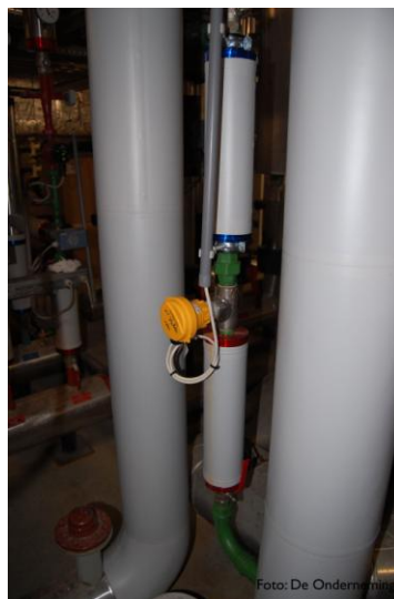
Voor de leiding naar een onderstation werd een intelligente evenwichtsleiding toegepast, met debietmeting in de bypass.
